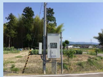
池ノ端MHポンプ盤(阿賀野川流域)
