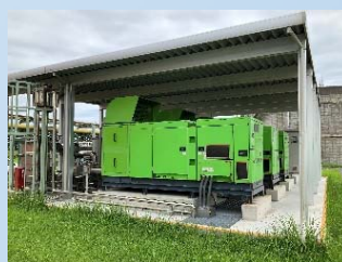
消化ガス発電設備
