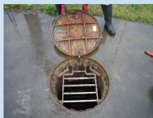
マンホール腐食状況調査
